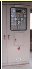
取水放流設備 (機側操作盤)
